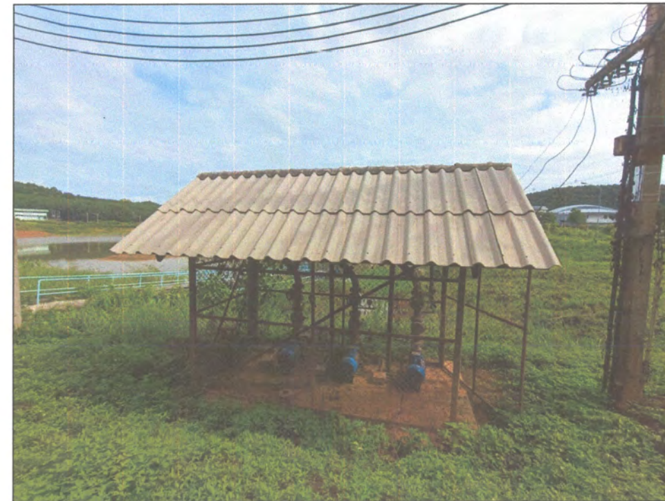
ชุดปั้มและมอเตอร์ไฟฟ้า
