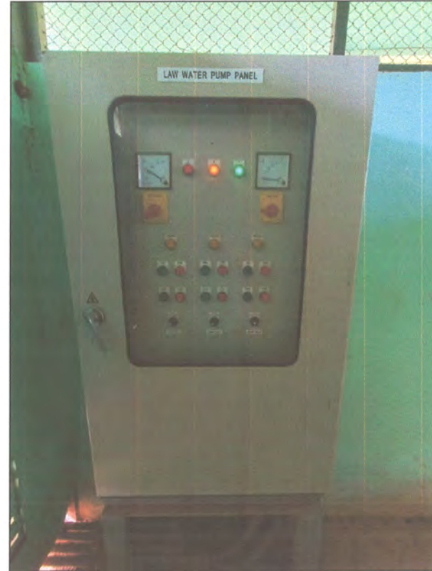
ตู้ควบคุมปั้มน้ำ ชุดเล็ก
