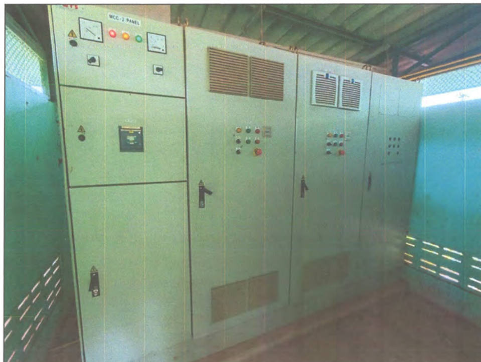
ตู้ควบคุมไฟฟ้า MDB และชุดสายไฟฟ้า
