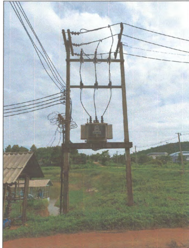
หม้อแปลงไฟฟ้า
