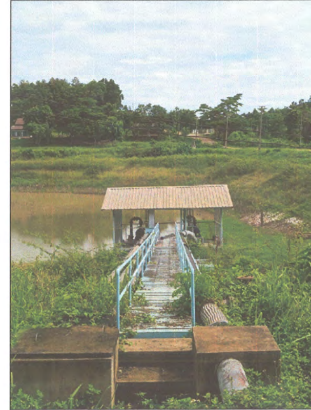
ชุดปั้มและมอเตอร์ไฟฟ้า
